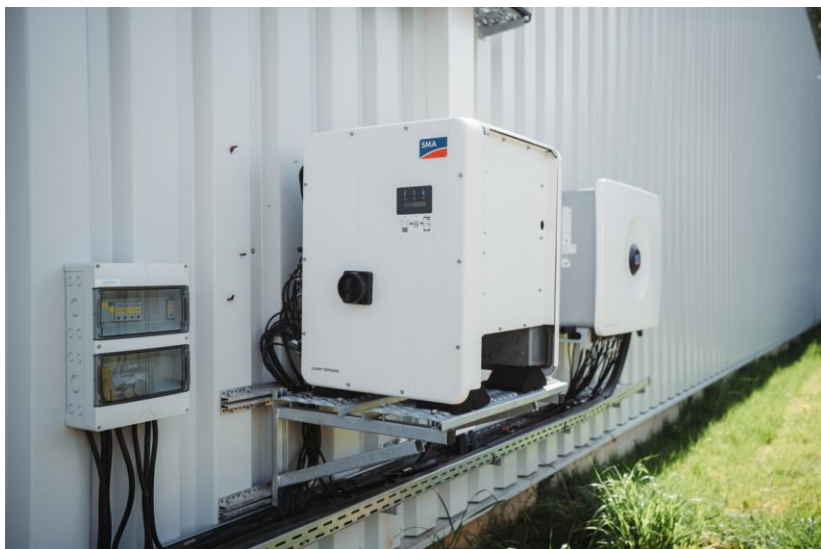
Fokus auf Qualität: Installation von drei Wechselrichtern „Made in Germany“
